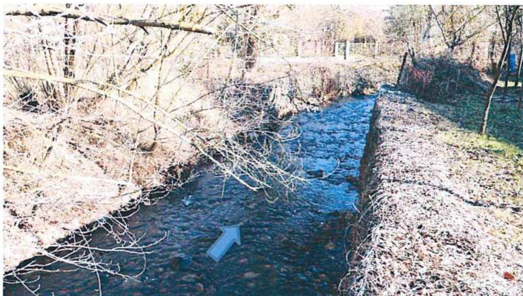
A kőfal kevésbé károsodott alsó szakasza, felvizi irányból nézve (2024.01.26.)
