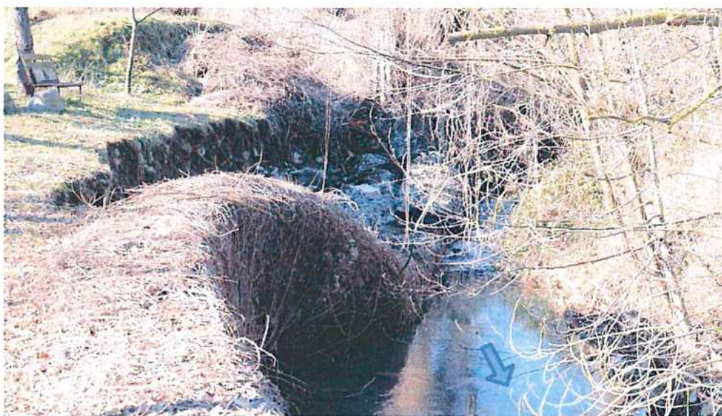
A bal parti kőfal károsodott szakasza, alvizi irányból nézve (2024.01.26.)
