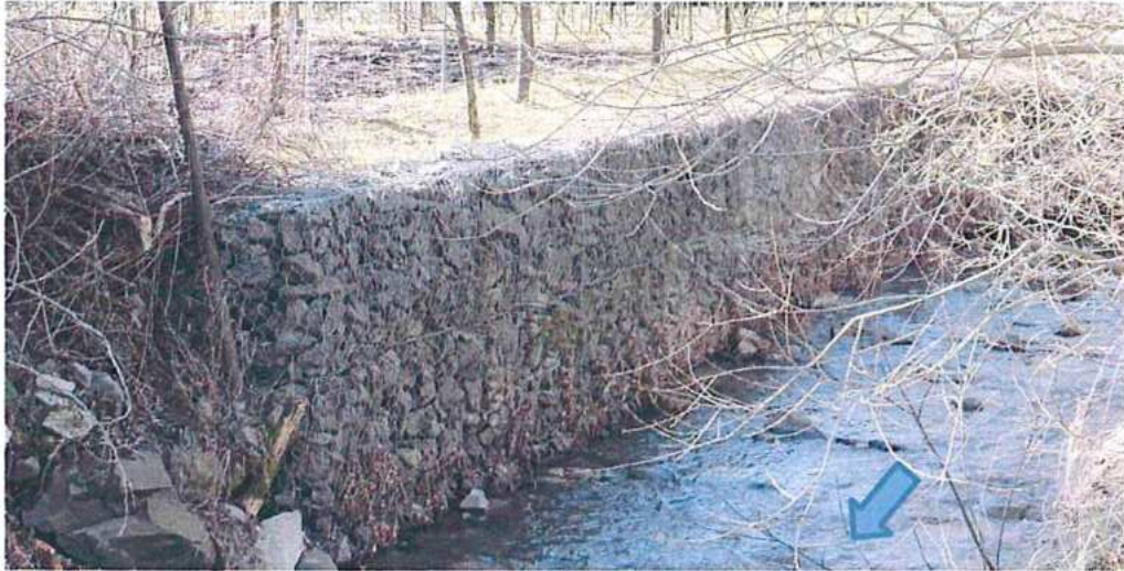
A kőfal alsó szakasza, alvizi irányból nézve (2024.01.26.)
