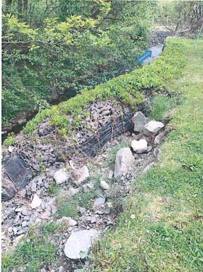
A kőfal kevésbé károsodott alsó szakasza, felvizi irányból nézve (2024.04.22.)
